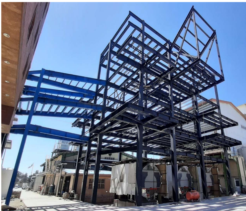
سازه فلزی صنعتی شرکت لبنی کالین در شهرک صنعتی صفادشت - خرداد ۱۴۰۲
